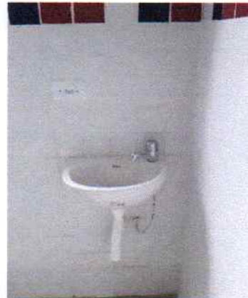
FOTO 6 - VISÃO INTERNA DO POSTO DETALHE DA PIA DE LOUÇA ASSENTADA, TORNEIRA CROMADA
