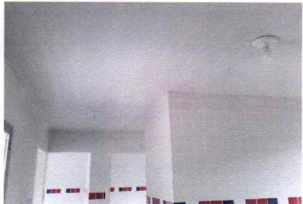
FOTO 4 - VISÃO INTERNA DO POSTO DETALHE DO FORRO EM PVC INSTALADO
