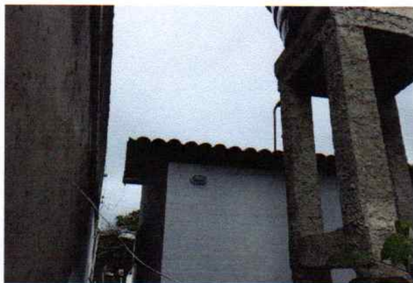
FOTO 11 - VISÃO EXTERNA DO POSTO - DETALHE DA ILUMINAÇÃO EXTERNA EXECUTADA CONFORME PROJETO
