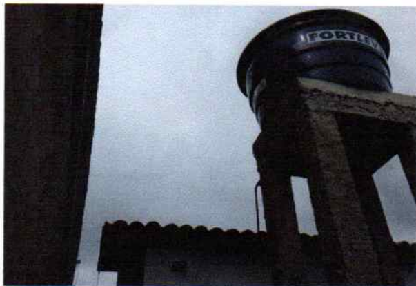
FOTO 7 - VISÃO EXTERNA DO POSTO DETALHE DA ESTRUTURA DA CAIXA D'ÁGUA EXECUTADA, E CAIXA D'ÁGUA INSTALADA NO LOCAL CONFORME PROJETO
